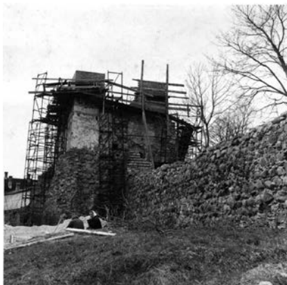
16. Pietryčių bokštas vykdamant restauravimo darbus, apie 1965, nuotrauka iš Jono Glemžos asmeninio archyvo South-eastern tower under conservation (ca. 1965)
