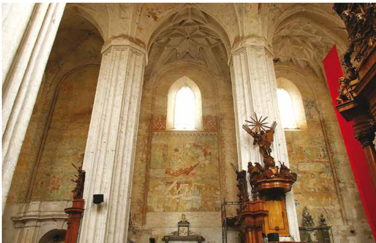
7. Vilniaus Bernardinų bažnyčia, šiaurinė siena. Būklė prieš restauravimą, Daumanto Tomo Pilipavičiaus nuotrauka, 2009 Northern wall of the Vilnius Bernardine church. Condition before restoration
